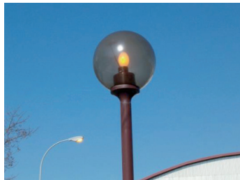
Luminaria esférica sin reflector con alta contaminación lumínica al hemisferio superior.
