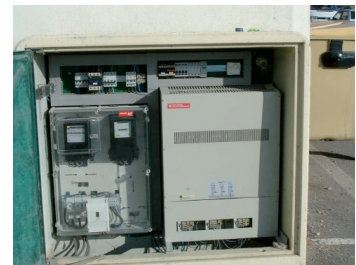
Cuadro de mando con equipo centralizado de reducción de flujo.
